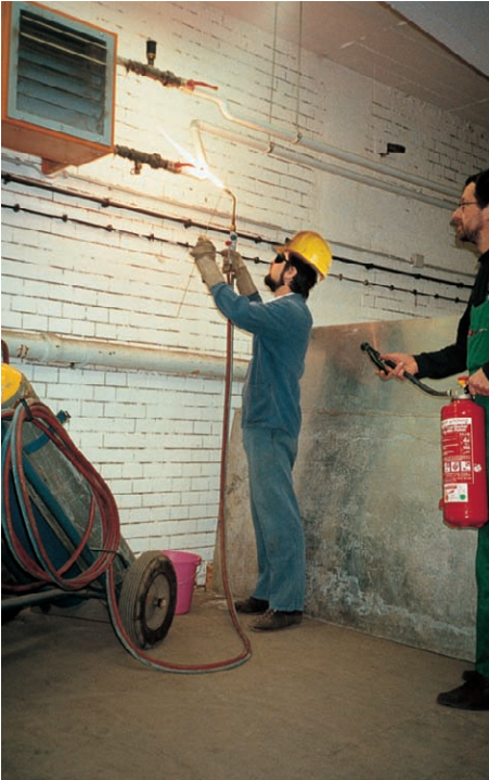
Bild 3: Schweißer mit Schutzbrille und Schutzhandschuhen beim autogenen Schweißen. Ein zweiter Mann steht mit Löschgeräten als Brandwache einsatzbereit. Brennbare Gegenstände, die nicht aus dem Umkreis der Schweißstelle entfernt werden konnten, sind durch Blechtafeln gegen Flammen, Funken und glühende Metallteilchen geschützt.
